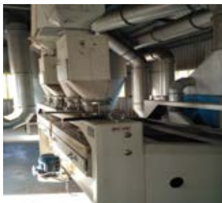
Рисунок 8. Комплекс по очистке и сушке зерна. Очистительные машины (ООО «Нерал-Буздяк»)
