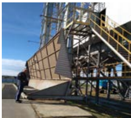
Рисунок 7. Комплекс по очистке и сушке зерна. Приемный бункер.
